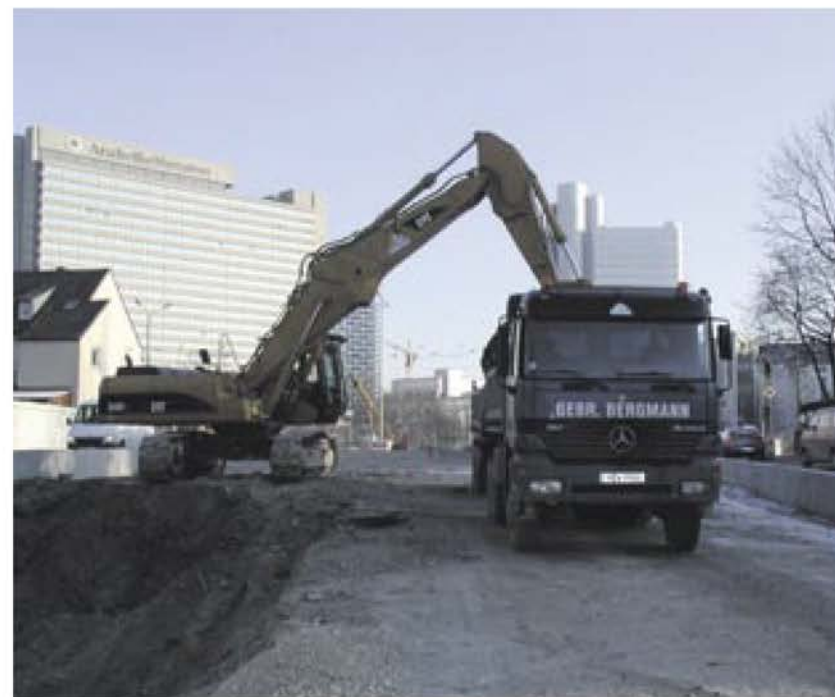
Selbstverständlich müssen alle Arbeiten so abgewickelt werden, dass der Verkehr am Mittleren Ring in München auch während der Bauphase ungehindert fließen kann, obwohl nur sehr wenig Platz zur Verfügung steht. Fotos: Zeppelin
